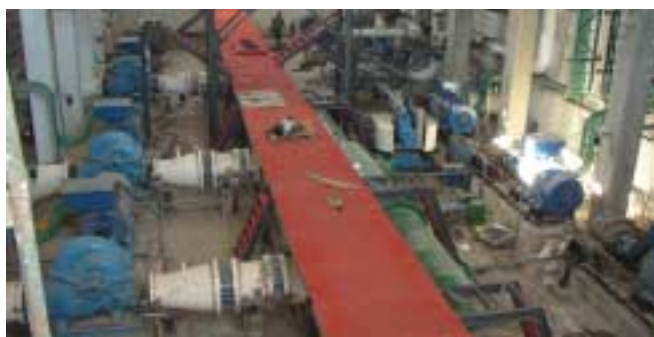
Fig. 4. Galería de bombas y tuberías del sistema de pre-tratamiento.
