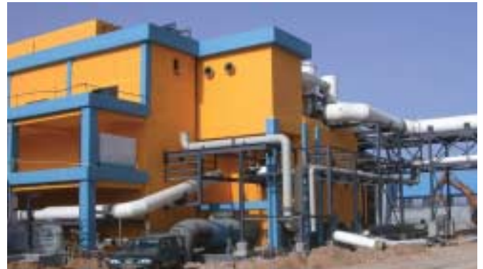
Fig. 8. Sistema de post-tratamiento.
