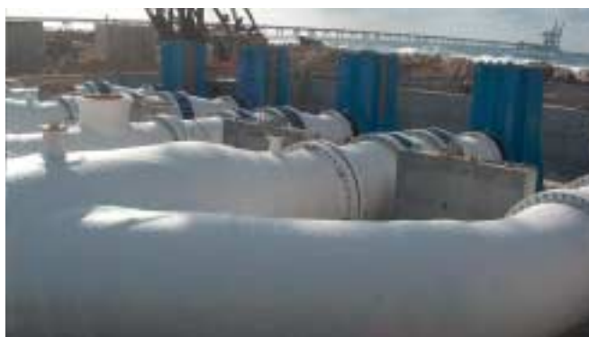
Fig. 3. Estación de bombeo de agua de mar de alimentación.
