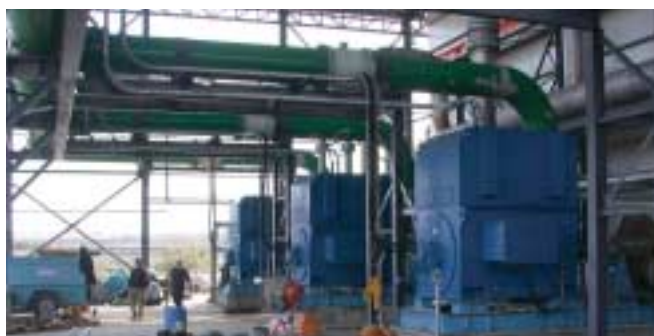
Fig. 5. Bombas de alta presión.
