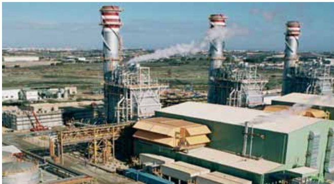
Fig. 5. Central de ciclo combinado de Palos de la Frontera, 3 x 400 MW.
