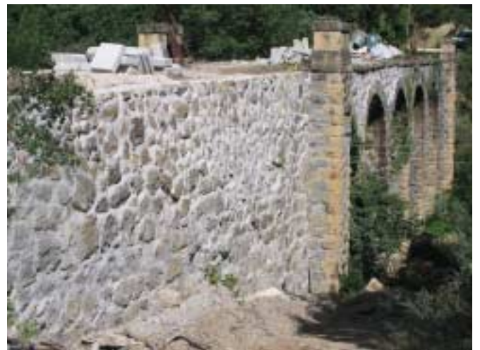
Fig. 5. El mismo estribo del puente sobre el río Sabando, ya avanzada la rehabilitación.
