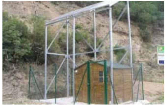
Fig. 3. Recinto donde se instalaron los paneles solares y la caseta que alberga las baterías, reguladores, interruptores, etc. de la iluminación del túnel de Barbadillo de Herreros (Burgos), en curva y con 175 m de longitud.
